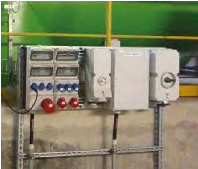
Salzgitter AG, Kraftwerk 4, Salzgitter, Deutschland
