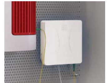
Beispiel: Installation im Multimediaverteiler.
