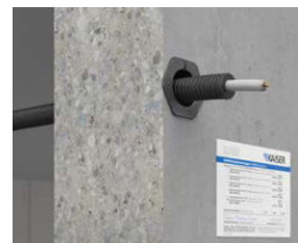
Wanddurchführung durch Brandschutzwand aus Beton.
