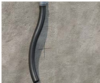
Mauerwerk mit Rohraustritt.
