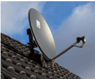
Anschluss einer digitalen Satelliten-Empfangsanlage.
