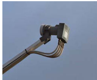
Hier werden 4 Koaxial-Leitungen für den Empfang angeschlossen.
