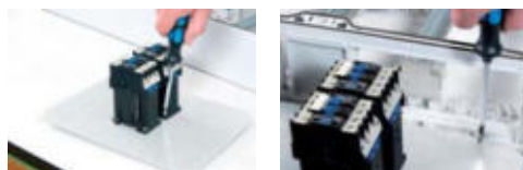
Geräteeinbau auf Montageplatte
