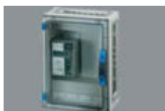
Zählergehäuse mit elektronischem Haushaltszähler (eHz)
