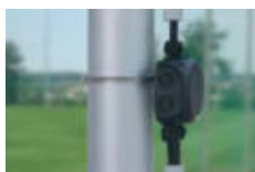
Beleuchtungssteuerung eines Sportplatzes
