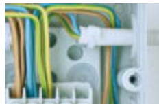
Zugentlastung mit einem Kabelbinder zur Befestigung auf dem Boden
