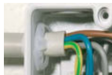
Zugentlastung über Rückhalteringe für Kabel
