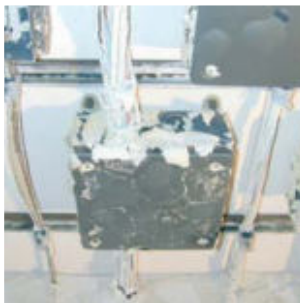
Gehäuse mit angeschlossenen Kabeln nach dem Test.
