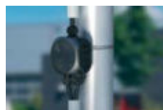
Energieversorgung einer Überwachungskamera im öffentlichen Raum
