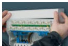
Optisch saubere Installation durch beigefügte Kabeleinführungsblende
