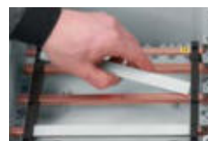
Sammelschienen-abdeckung zum Isolieren
