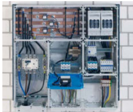
Messung mit Wandlergehäuse, Stromwandlern und Messgerätegehäuse
