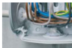
Zugentlastung über Rückhalteringe für Kabel
