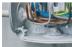
Zugentlastung über Rückhalteringe für Kabel
