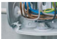
Zugentlastung über Rückhalteringe für Kabel
