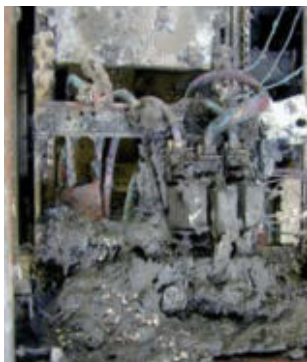
Nach einem Störlichtbogen ohne Störlichtbogenschutz.
