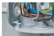
Zugentlastung über Rückhalteringe für Kabel
