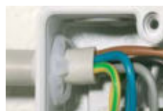
Zugentlastung über Rückhalteringe für Kabel
