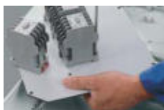
Geräteeinbau auf Montageplatte
